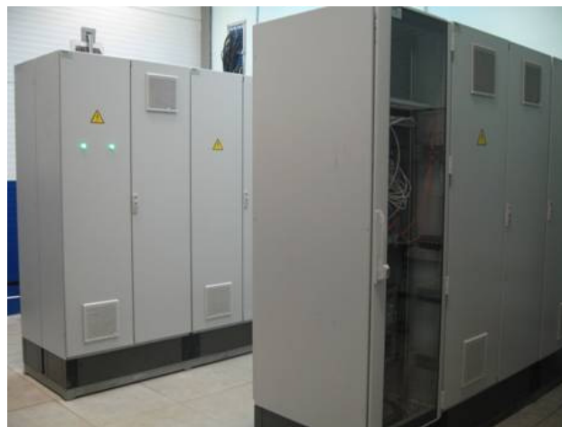
Рис. Помещение контроллерной
