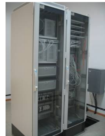
Рис. Помещение серверной
