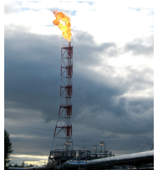
Рис. Розжиг нового факельного ствола
